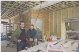
■ Er wordt al bijna een jaar verbouwd in de woning van Huibert Barons. Hier op de foto met zijn vriendin Marjolijn Kamslop
